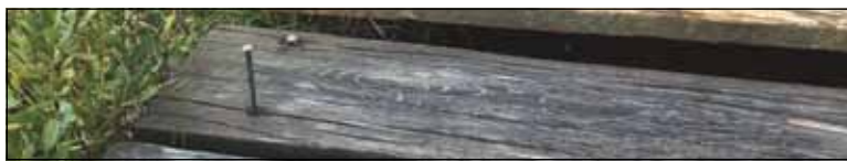
FÖRENAT MED FARA att ta sig över Svedsmossen via spången. Notera spiken som står upp...
